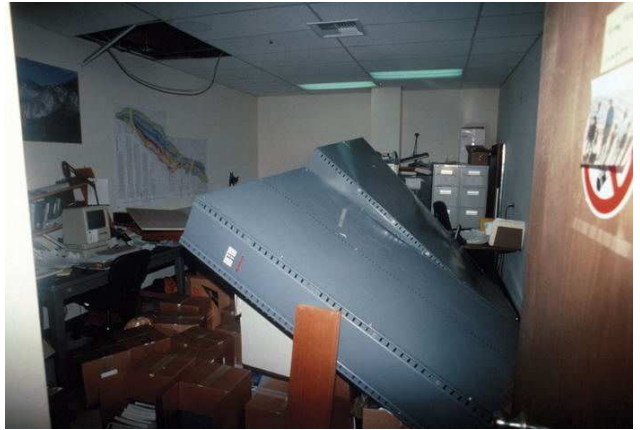
Bokskap som ikke var festet til veggen falt ned i hovedkontoret til USA's Geologiske Undersøkelse ved Menlo Park, California, under Loma Prieta jordskjelvet 17. Oktober 1989. Bilde VI-1. (Fra US Geological Survey Bildesamling på: http://libraryphoto.cr.usgs.gov Bilde VI-1 USGS Open File Report 90-547)
