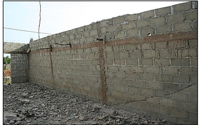
Pared dañada por el Monzón en Gambia.
