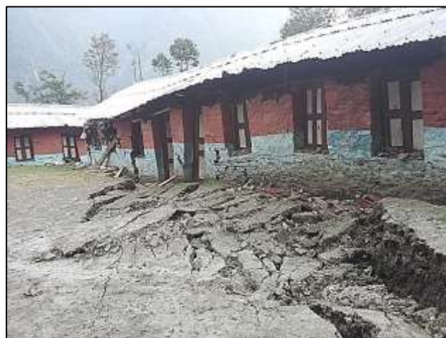
Una escuela dañada por un terremoto.
